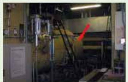
石棉含有保溫材（ボイラ外周部）
