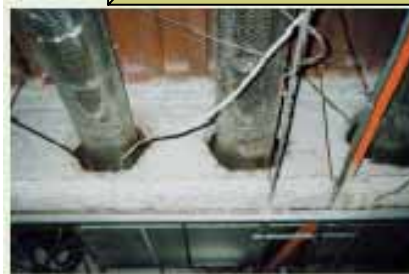
石棉含有アスベスト・石棉含有吹付ロックウール（5造の耐火被覆）
