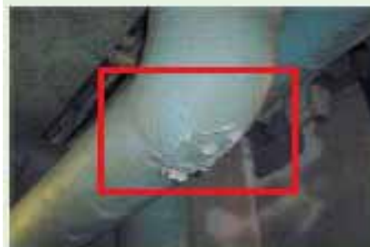
石棉含有保溫材（配管仕切り部）
