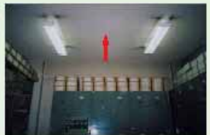
石棉含有パーミキュライト吹付（天井）
